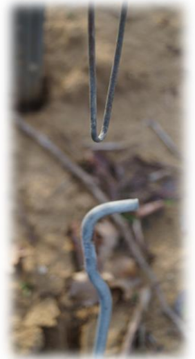
Photo 1 Déformation de la rallonge.
